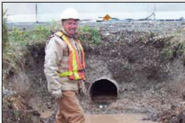
Ponceau engorgé de sel de voirie et de sable
