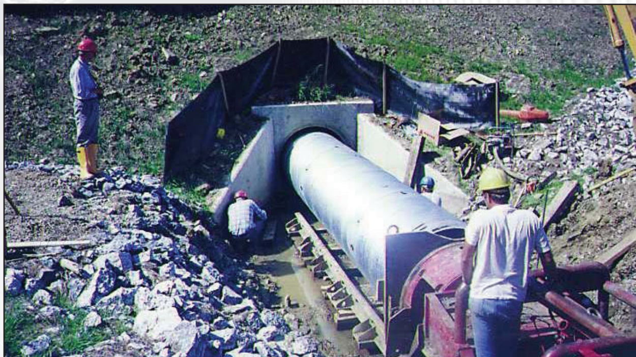
Mise en place du TTO de garnissage par levage dans le tuyau de béton hôte – réparation dans remblai profond
