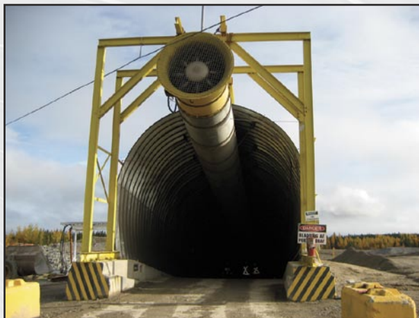
PORTAIL D'ENTRÉE DES CAMIONS AVEC VENTILATEUR D'AÉRATION SUPÉRIEUR
