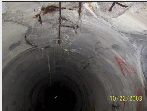
TUYAU D'ÉGOUT RIGIDE FISSURÉ ET CORRODÉ
